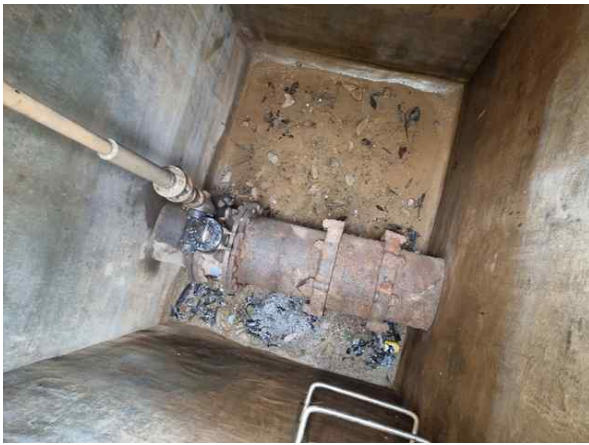
손상내용 유입밸브실(1지) 관부식 손상원인 공용기간 증가 등
