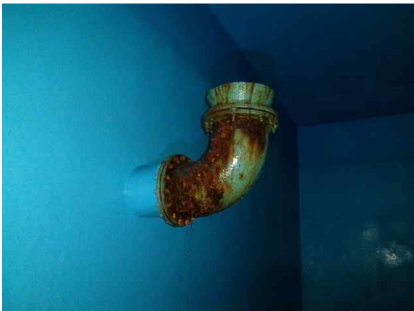
손상내용 2지 유입 관부식 손상원인 온도차에 따른 습기흡착 등
