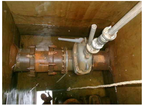
손상내용 유출밸브실(1지) 관부식 손상원인 온도차에 따른 습기흡착 등
