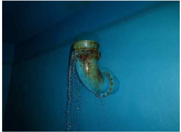
손상내용 1지 유입 관부식 및 차수불량 손상원인 공용기간 증가 등
