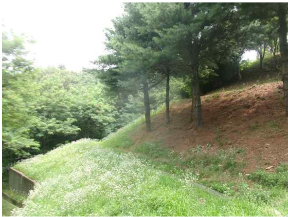
손상내용 사면 상태양호
