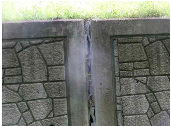
손상내용 옹벽 실링재 열화
