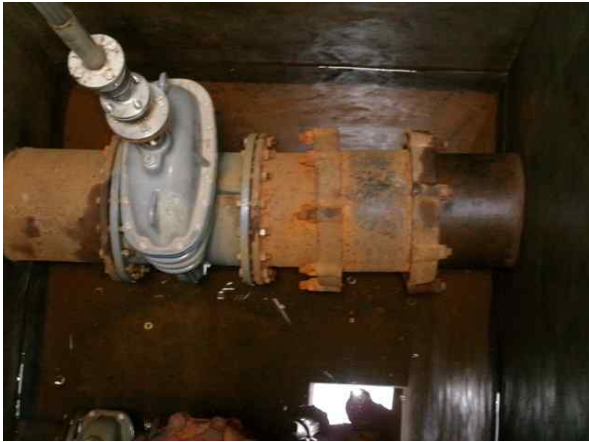
손상내용 유출밸브실(2지) 관부식 손상원인 온도차에 따른 습기흡착 등
