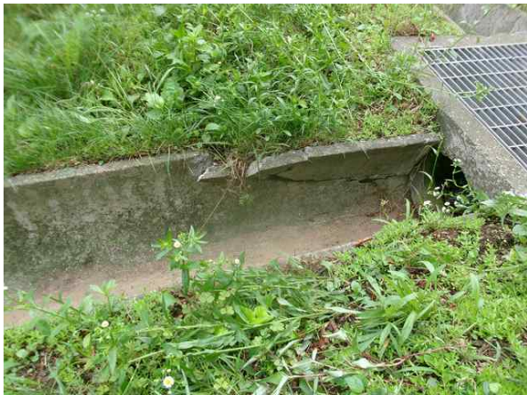
손상내용 배수시설 배수로 파손
