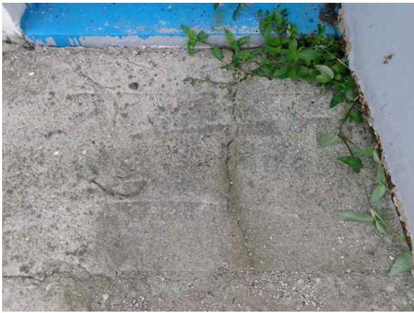
손상내용 계단실 외부 바닥 균열 손상원인 건조수축, 온도변화 등
